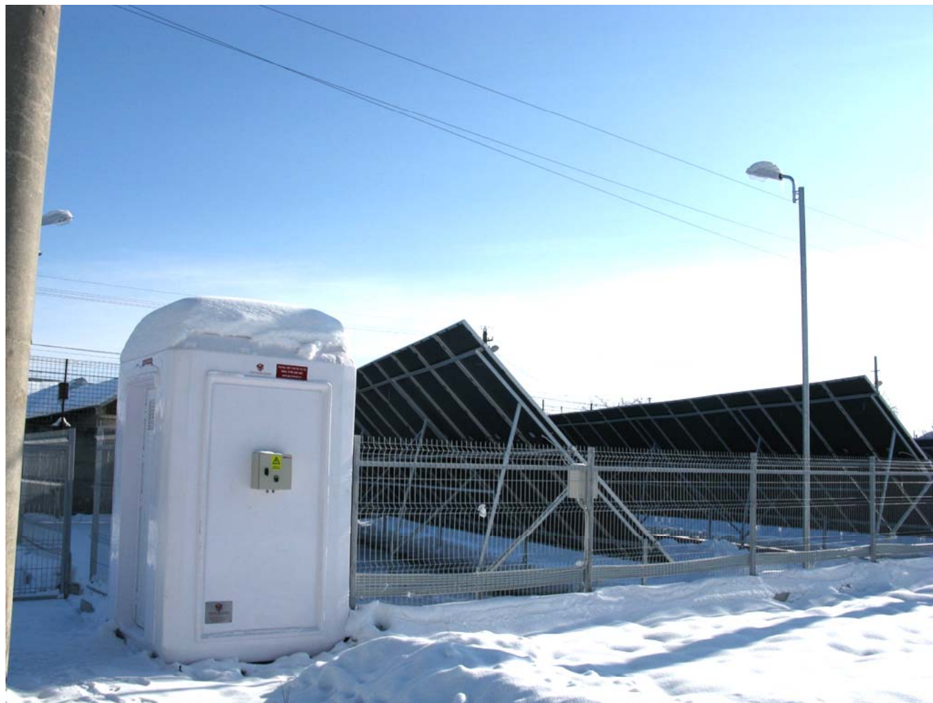
Panouri și cabina invertoarelor
